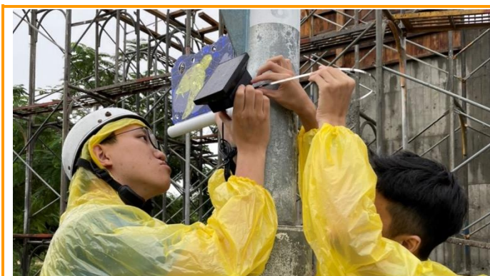
小琉球智慧車聯網輕旅導入計畫-學生於小琉球電線杆上架設基地台
